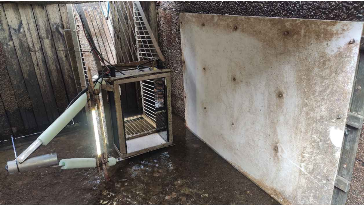
Kuva 2. Koivukosken voimalaitoksen kalaportaaseen asennettu Vaki-kalalaskuri, ohjauskehikko sekä kalojen lajintunnistuksessa apuna käytetty videokamera valoineen.
